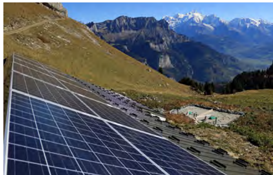
Panneaux solaires photovoltaïques sur le refuge de l'alpage de Vormy (Nancy-sur-Cluses)
