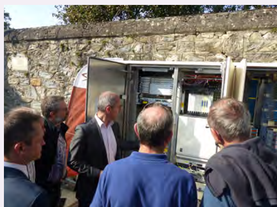
Vue d'un central optique fibré
