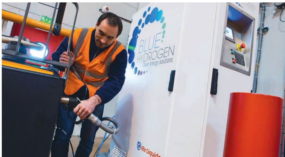
Station de ravitaillement à Prelocentre, Saint-Cyr-en-Val, qui permet de ravitailler plus de 60 chariots élévateurs en hydrogène.
