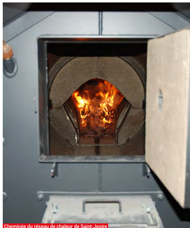
Cheminée du réseau de chaleur de Saint-Jeoire
