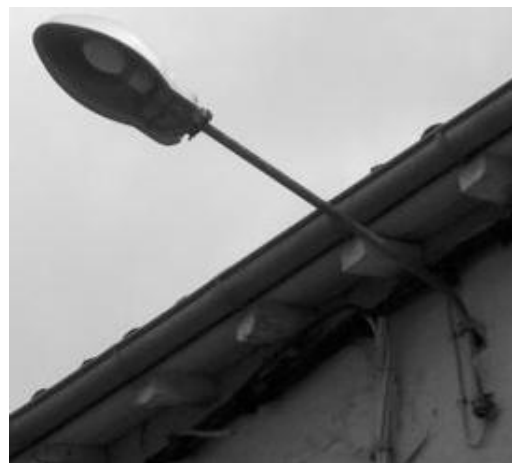
1 point lumineux 1 foyer lumineux standard vétuste
