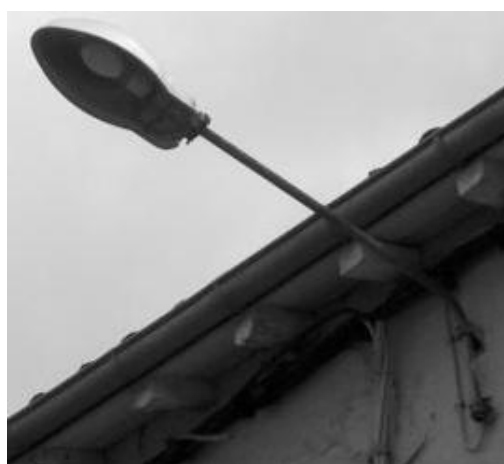
1 point lumineux 1 foyer lumineux standard vétuste
